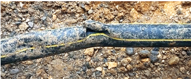
Beschädigte und nicht mehr betriebssichere Rohroberfläche
