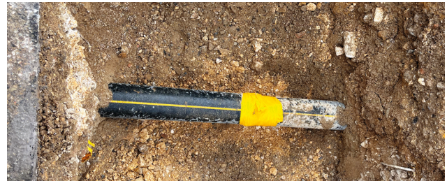
Von einem Spitzisen durchtrennte Leitung
