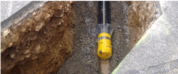
Schaden an einer Werkleitungskreuzung
