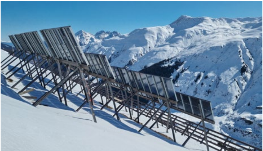
Alpine Photovoltaik-Grossanlage «Sedrun Solar», Tujetsch, Schweiz
