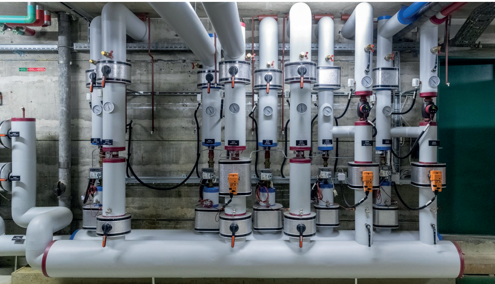
WKK-Anlagen produzieren neben Wärme auch Strom.
